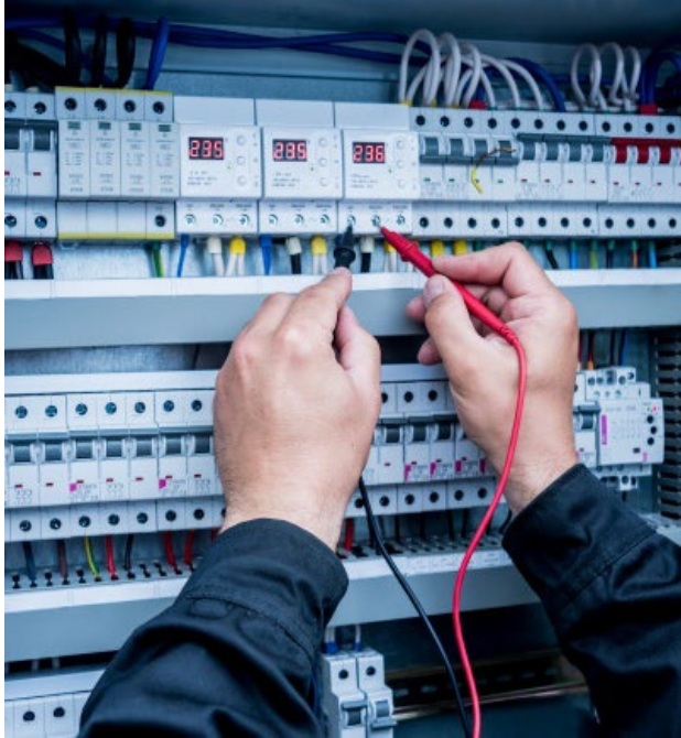
Elektriciteit Metingen - controles
